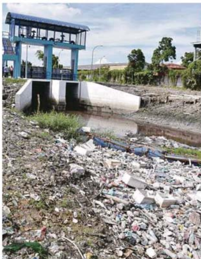
州府耗資280万令吉拨款给水利灌溉局提升班村巴板路水閘口，大沟却充斥许多垃圾，尤其是保丽龙箱，恐令治水工作徒劳无功。
